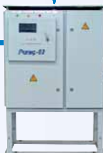
Станция управления РИТЭКС-03
